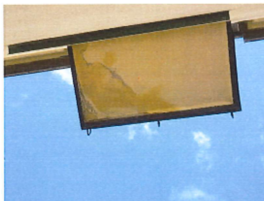
Balkongplatta missfärgad undersida
