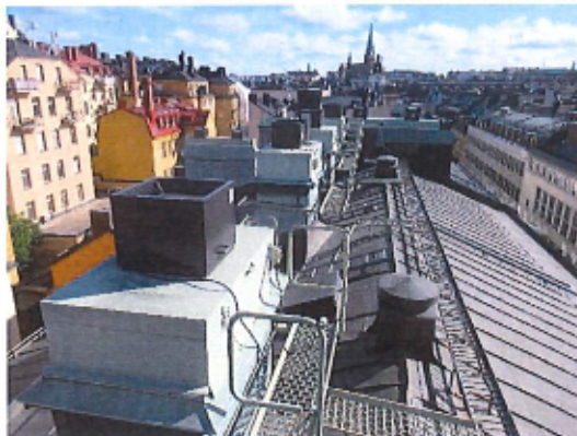
Yttertak med takfläktar
