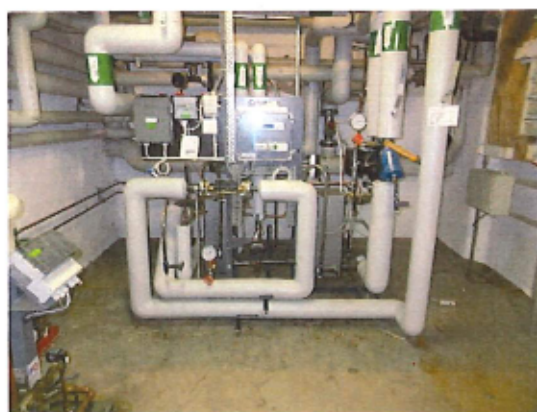
Undercentral för värme och varmvatten
