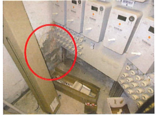
Fuktig mur vid elmätare
