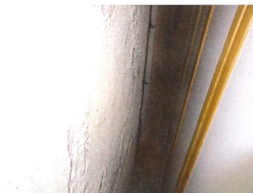
Fuktgenomslag grundmur bakom arkivet
