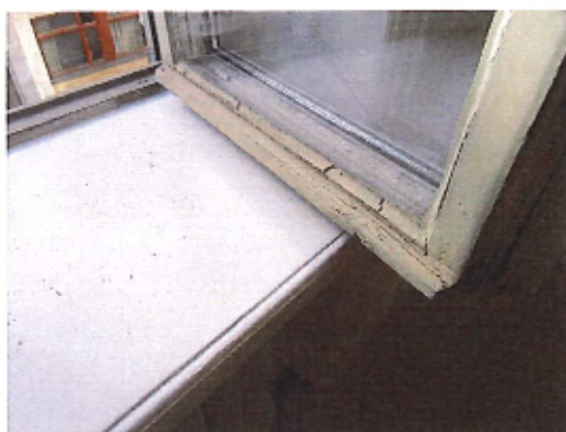
Fönster i behov av underhåll
