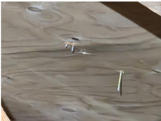
Fuktfläck på underlagstak.
