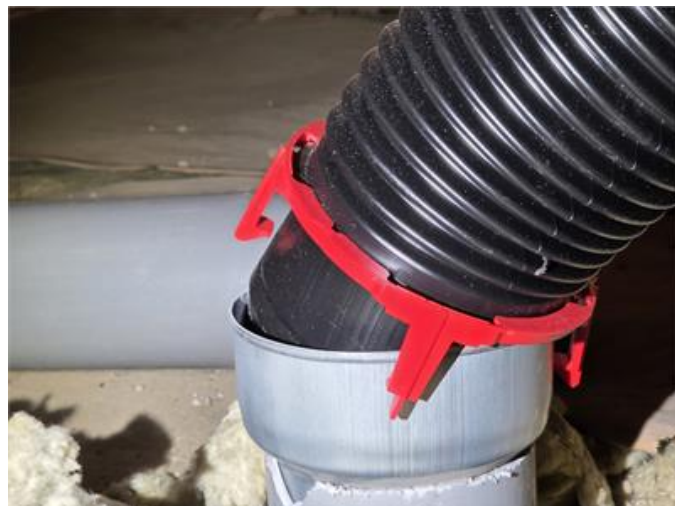
Avloppsavlftningen är otät.
