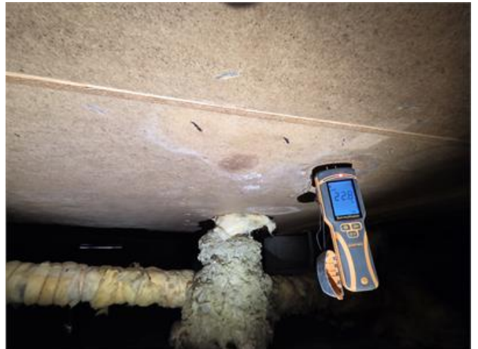
Skador på blindbotten
