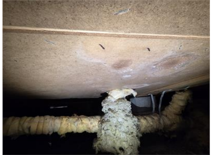
Skador på blindbotten
