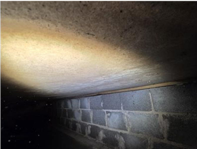
Skador på blindbotten
