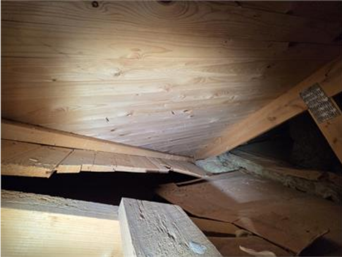
Fuktfläck på underlagstak.
