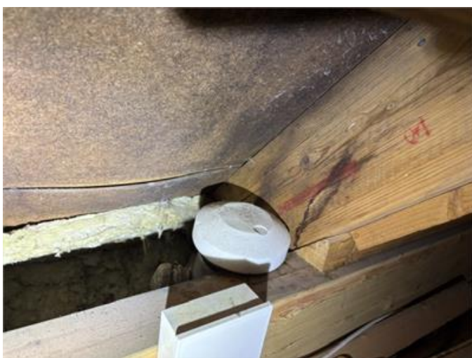
Bilden visar avloppsluftarens backventil.
