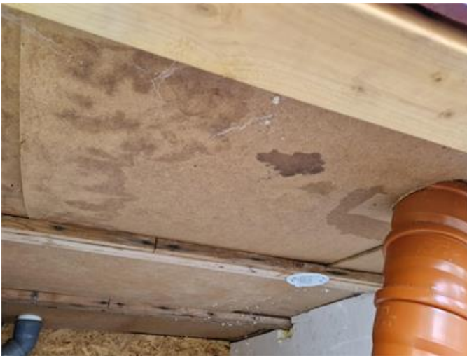
Plintgrund: Fuktfläckar förekommer i isolerat teknikutrymme
