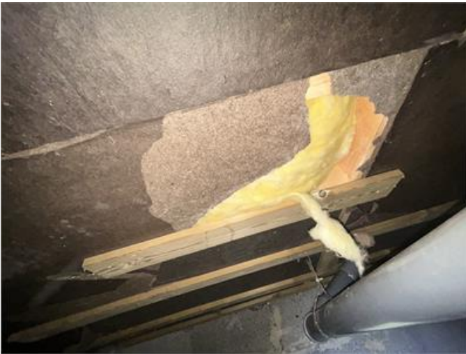
Krypgrund: Blindbotten skivor ej komplett.
