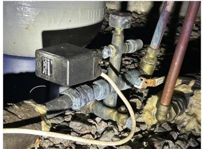
Krypgrund: Ärgade kopplingar noteras inutrymmet.
