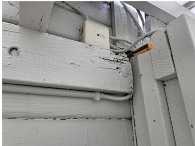
Rötskador förekommer i stolpar och bärlina.
