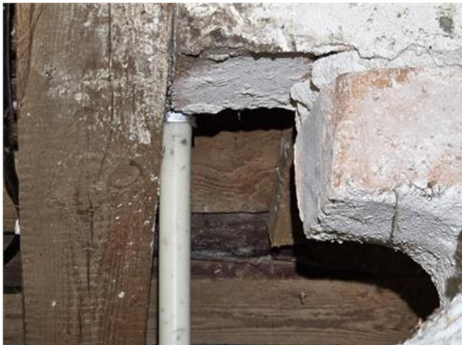
Mikrobiell påväxt på vinden.
