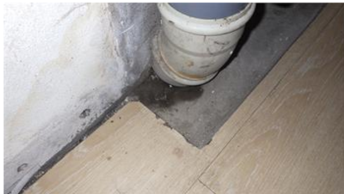
Fuktfläck på golvet vid avloppsröret i allrummet
