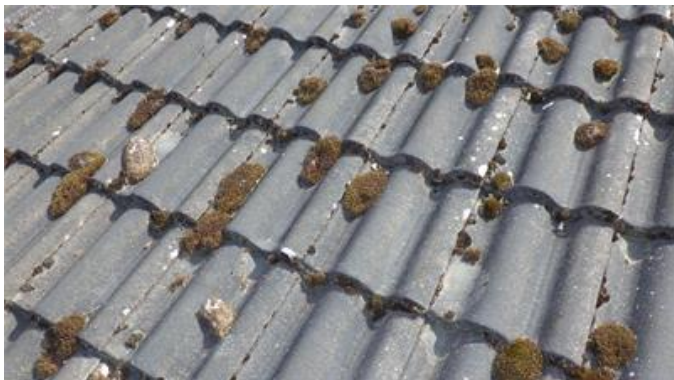
Mossa på takpannorna
