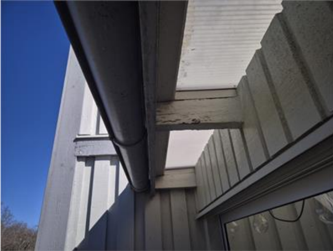
Fuktskada i taksparre till uterum.
