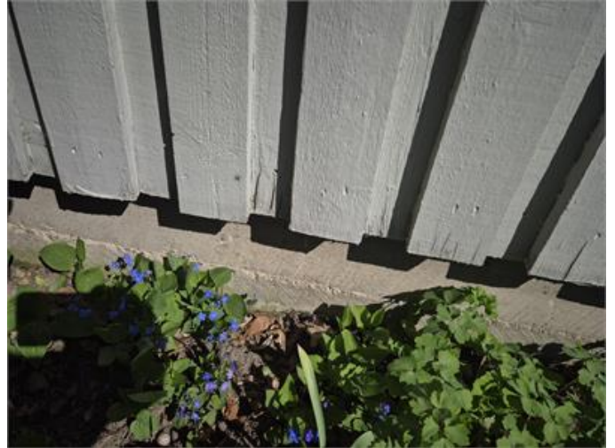
Det förekommer någon lokalt fukt/rötskadad beklädandsbräda.
