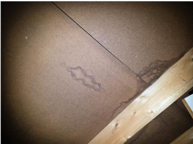
Fuktfläck på vindens underlagstak.
