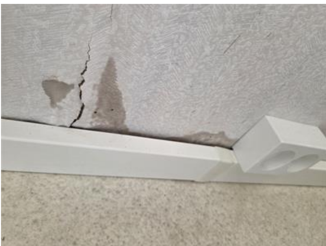
Fuktfläck på vägg/golvvinkeln i sovrum 2/3
