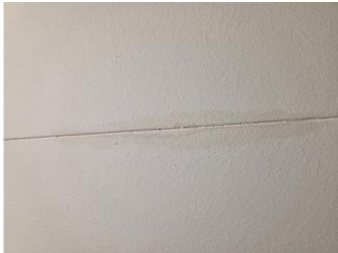
Fuktfläck på tak i sovrum 2/3
