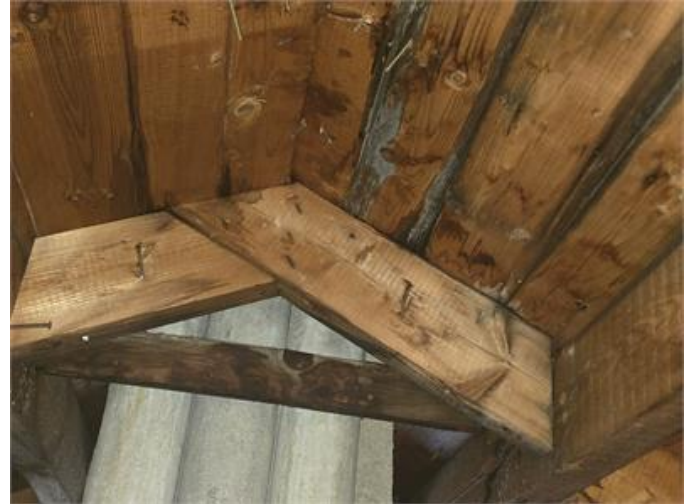
Exempel på fuktfläckar på del av underlagstaket.
