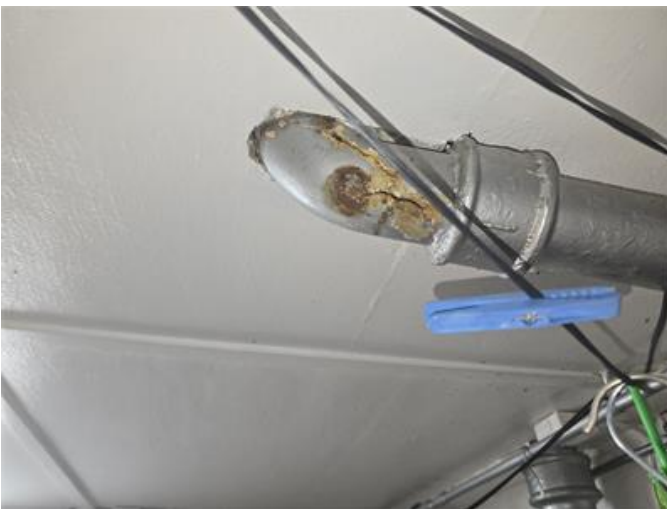
Bilden visar en spricka i ett avloppsrör.
