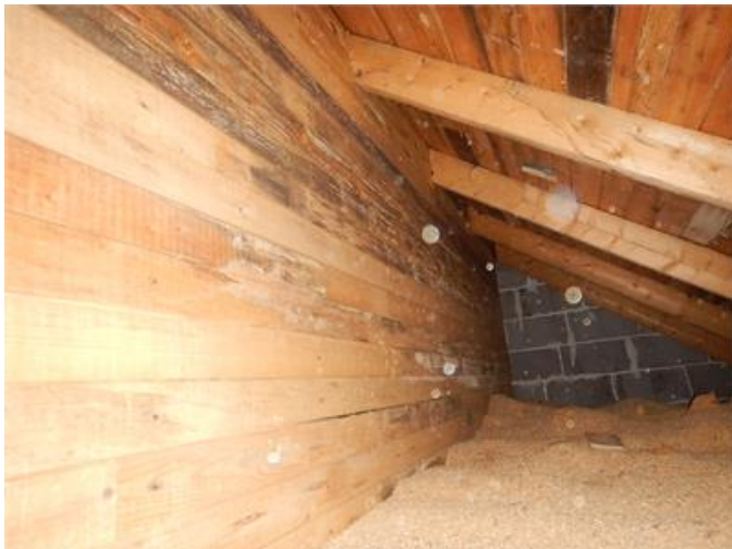
Mikrobiell påväxt på underlagstak samt stödbensvägg.
