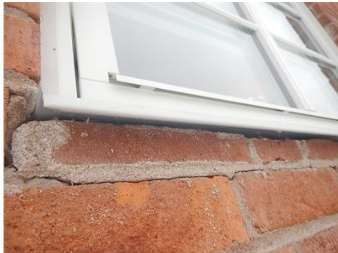
Sprickbildning och lösa tegelstenar på fasad.
