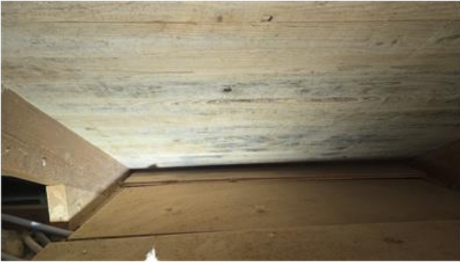
Exempelbild, mikrobiell påväxt underlagstak.
