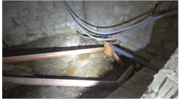
Pumpgrop/brunn för dagvatten placerad i krypgrund, fritt vatten på berg.
