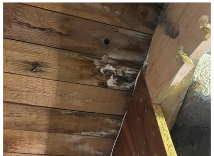
Nockvind: Fuktanvisningar med förhöjda värden i underlagstaket, främst runt murstocken. Mikrobiell påväxt förekommer i fuktanvisningar.
