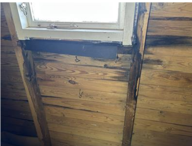
Nockvind: Fuktanvisningar runt fönster noteras.
