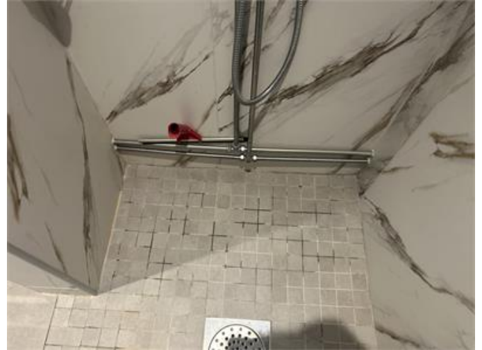
Dusch/WC: Rör genomföringar i duschzon och nära intilliggande vägg.
