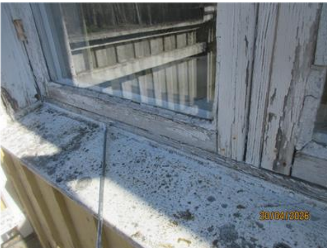
Äldre fönster har underhållsbehov alt bytes.
