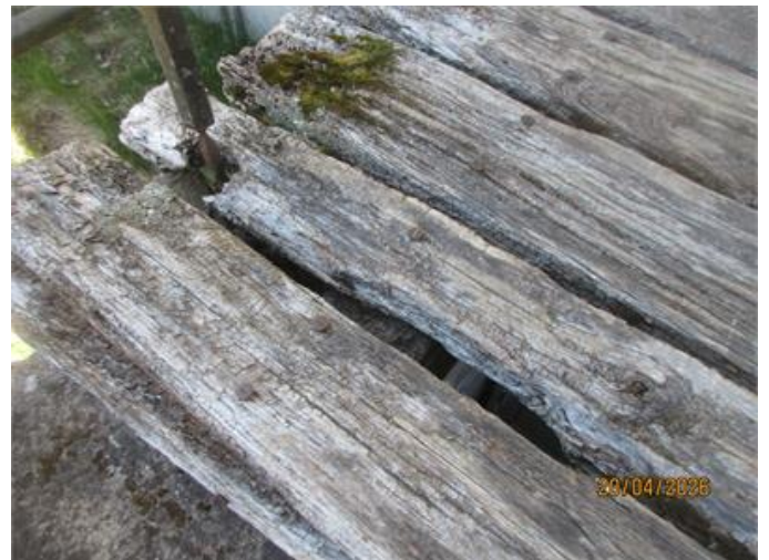
Skador på entrétrapp.
