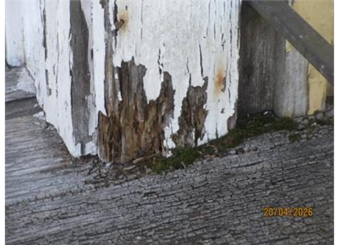
Fasadpanelen har skador , skador i bakomvarande konstruktioner kan inte uteslutas, åtgärdsbehov föreligger.
