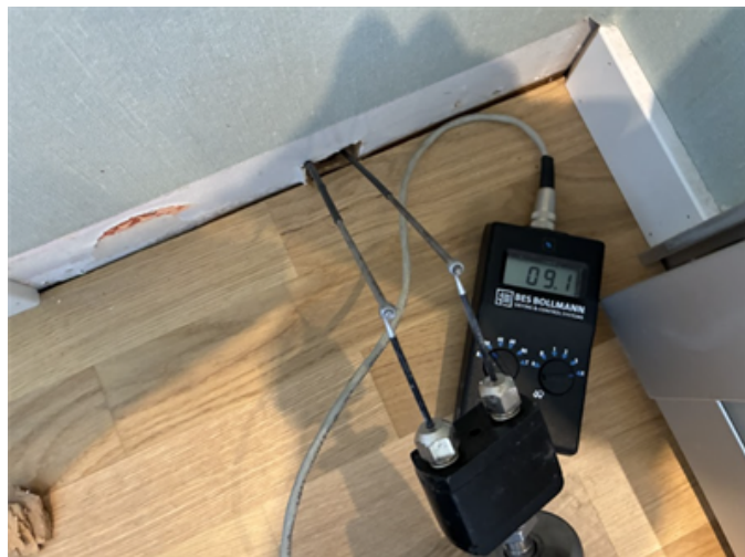
Bilden visar fuktkvotsmätning i sovrum. Gränsvärde är 17%.
