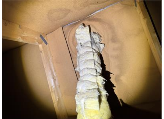
Fuktfläckar på underlagstak i vindsutrymmet.
