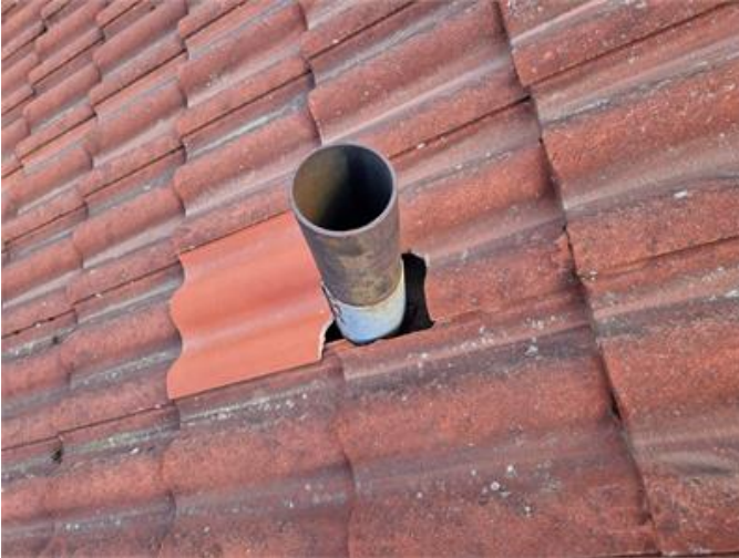
Tak: Otätheter noterades runt avluftningsrör
