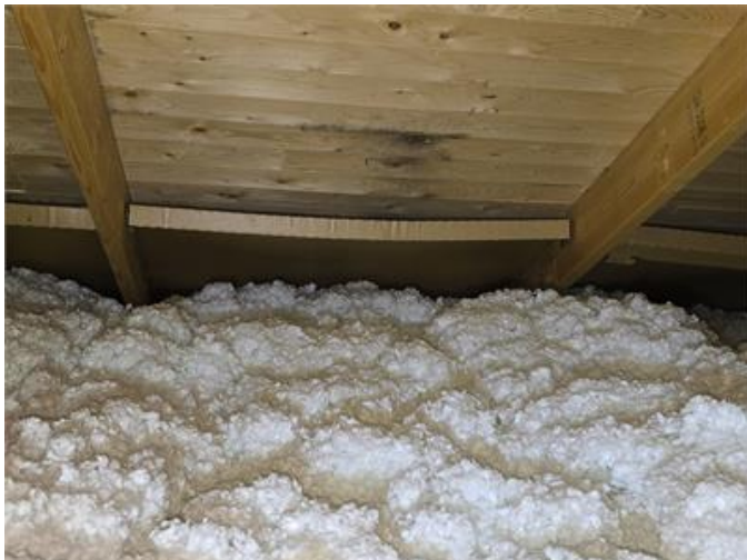
Nockvind: Ytlig mikrobiell påväxt noterades lokalt på underlagstak.
