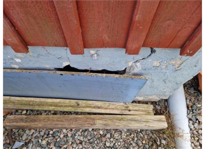
Krypgrund: Lucka mot krypgrund är ej tät.
