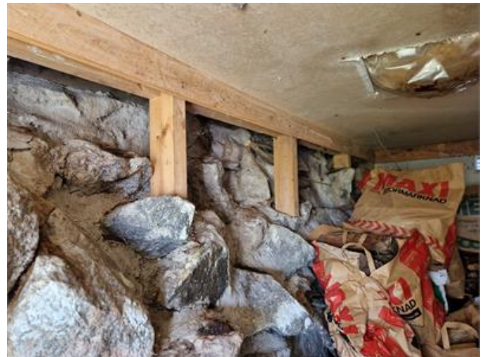
Gästhus/Utvändigt: Gästhusets konstruktion/anslutning mot garage bör kontrolleras och eventuellt åtgärdas.
