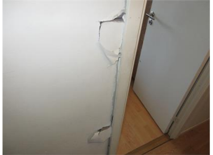
Skada i vägg till sovrums 1
