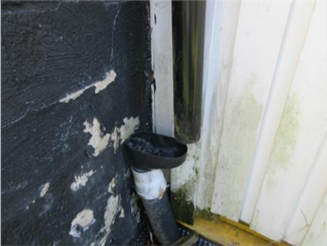
Stuprör är bristfälligt anslutet till dagvattenrör.
