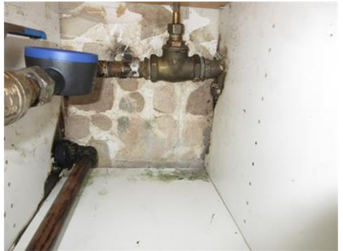
Mikrobiell påväxt i köksskåp källare
