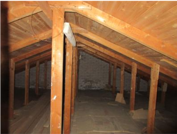
Synliga fuktgenomslag invändigt tegelfasad i vind
