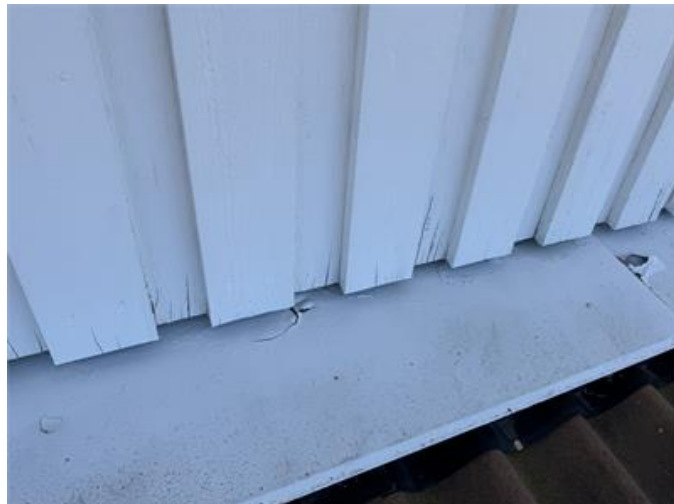
Torrspäckor noterades på fasadpanelens nederkant.
