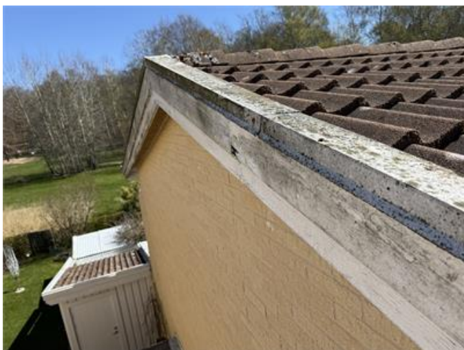
Rötskada i vindskiva (mot norr).
