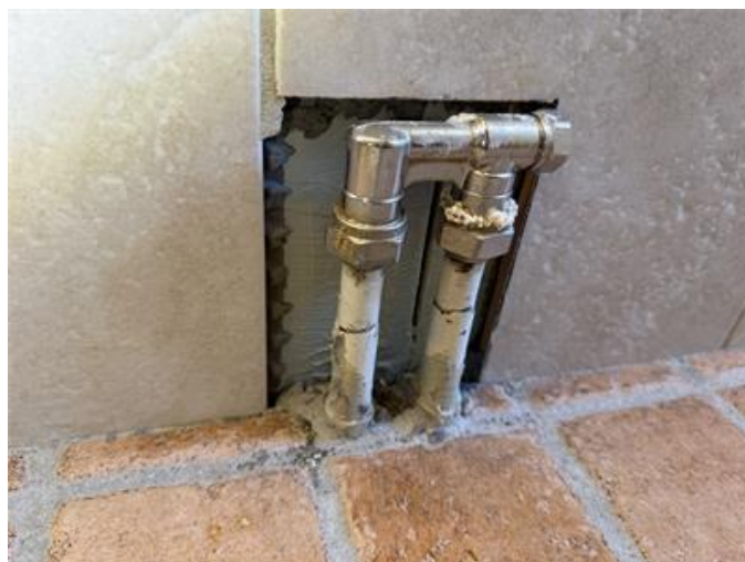
Olämpligt placerade rörgenomföringar i golvet i dusch/wc.
