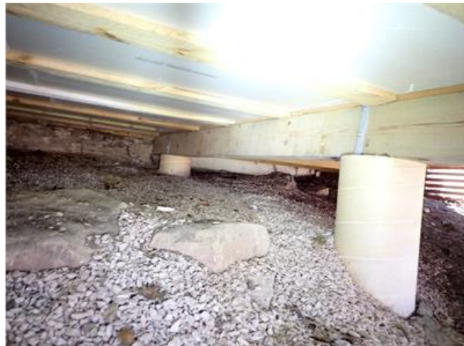
Exempel på rötskyddsbehandlat virke i plintgrund.
