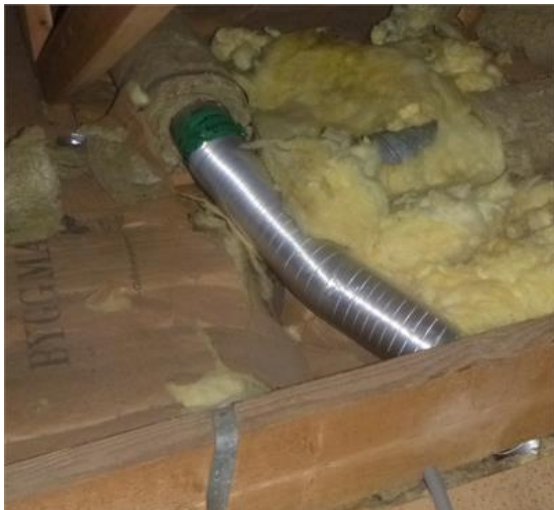
Bitvis oisolerad ventilationskanal på vind
