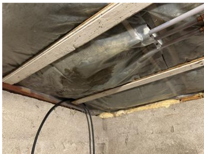
Fuktskada i golvbjälklag sett ifrån matkällare.
