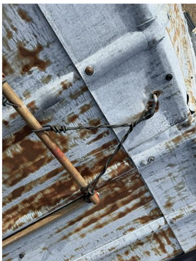
Takstegen är bristfälligt fastmonterad.
