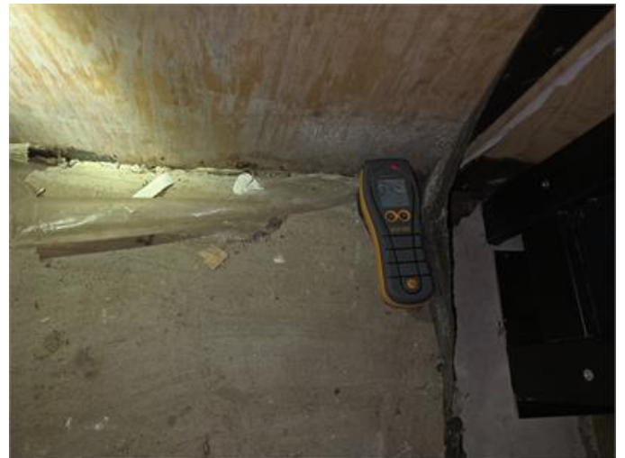
Påväxt och förhöjda fuktindikationer på väggskiva i källaren.
