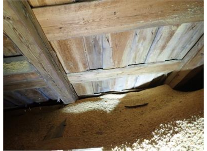
Fuktfläckar på underlagstak vind.
