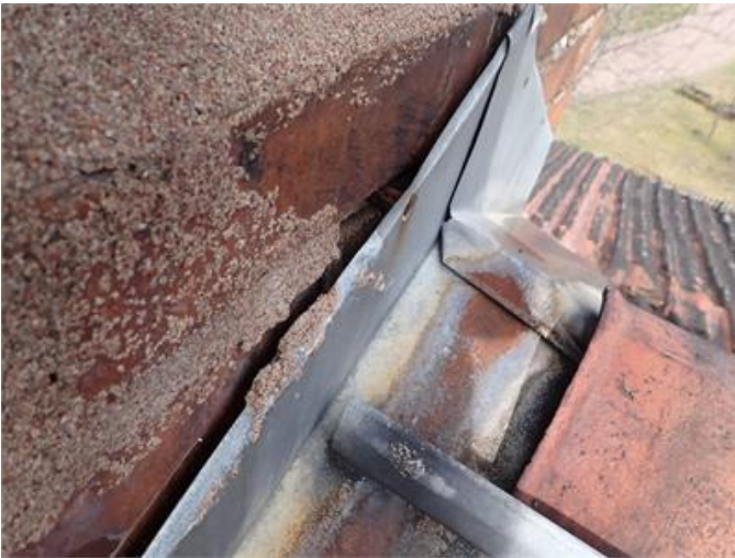
Otätthet mellan murstock och skorstensbeslag på tak.
