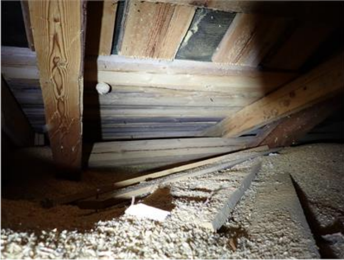
Mikrobiell påväxt på underlagstak ovan takkupa.
