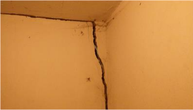
Spricka i källarvägg
