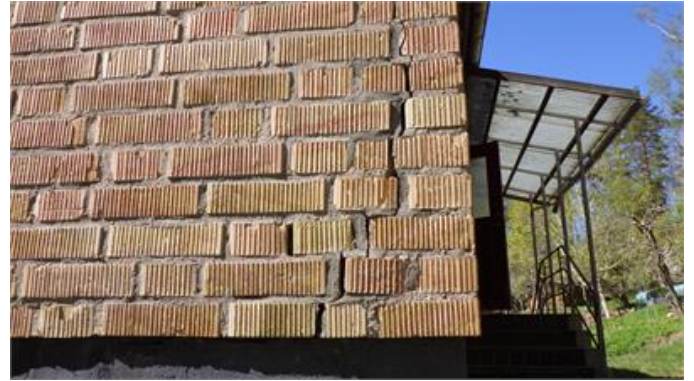
Spricka i husfasaden
