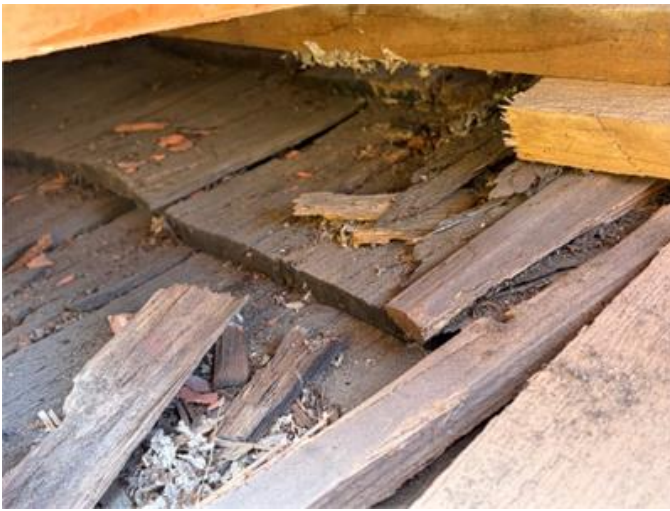
Undertaket takspån (sticketak) som bedöms ha ett försämrat motstånd mot vatten som letar sig förbi tegelpannorna
