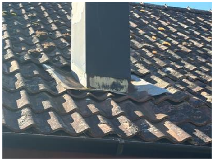
Nocktätning saknas och det förekommer bristfälligt monterade plåtar
