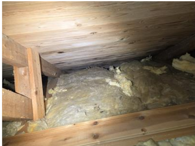
Fuktfläckar/missfärgningar & mikrobiell påväxt på underlagstak
