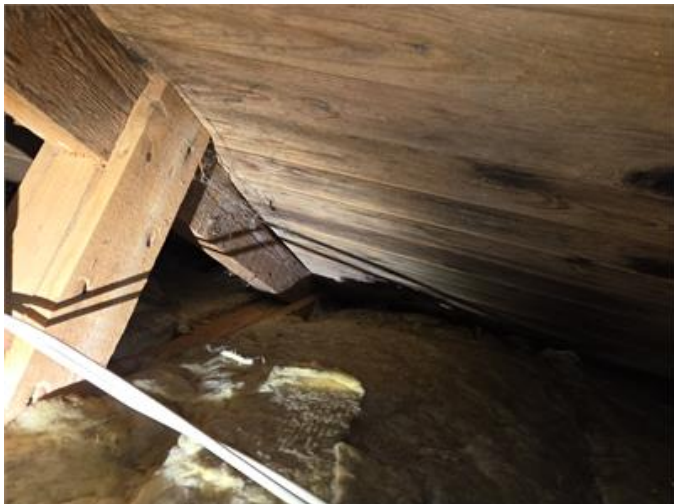
Fuktfläckar/missfärgningar & mikrobiell påväxt på underlagstak
