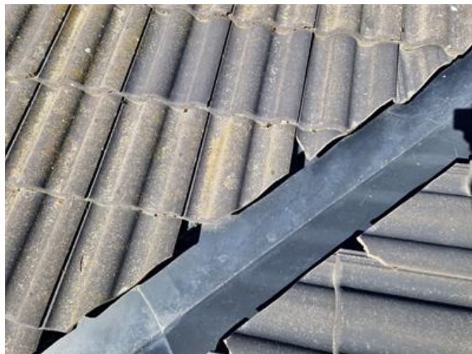
Tak: Takpannor täcker delvis dåligt över kant på rännalsplåtar.
