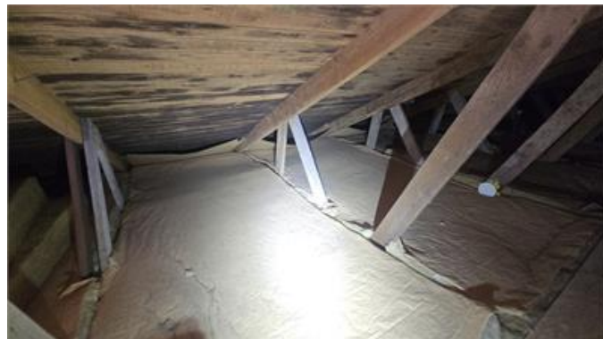
Exempelbild, mikrobiell påväxt underlagstak, vind.
