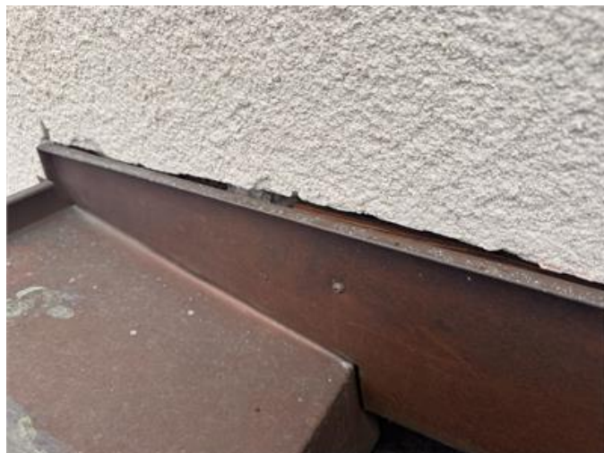
Otättheter i fasad vid plåtbeslag ovan tillbyggnad.
