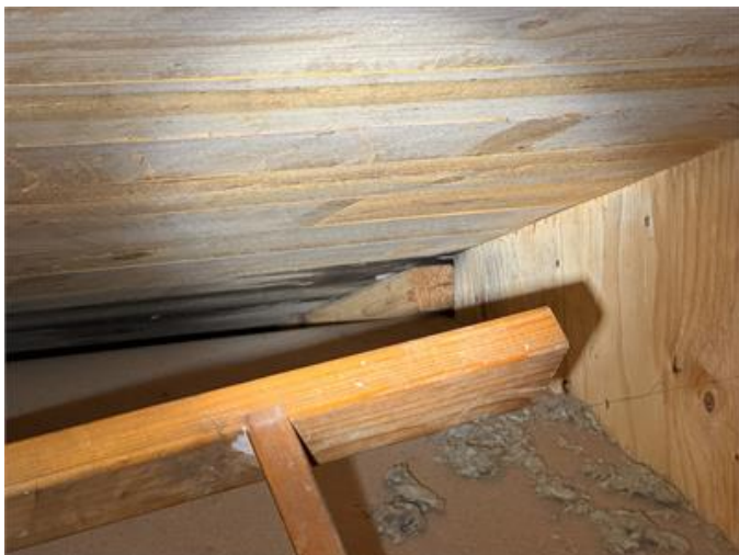
Läckage lokalt invid ventilationshuv.
