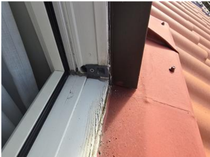
Exempel på otätheter mellan fönsterkarm/plåtkupa.
