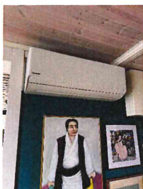
Lgh 1101, innerdel Luft-Luftvärmepump
