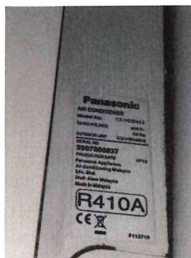
Innerdel för Luft-luftvärmepump Lgh 0901
