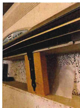
Innerdel till Luft-luftvärmepump källare
