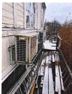
Utedel av Luft-Luftvärmepump för Lgh 1001 samt källare.
