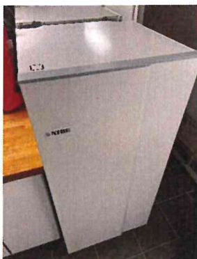
Varmvattenberedare i källaren för huvudbyggnaden
