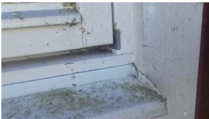
Exempelbild, målning/underhållsbehov fönster och otätheter kring bleck.
