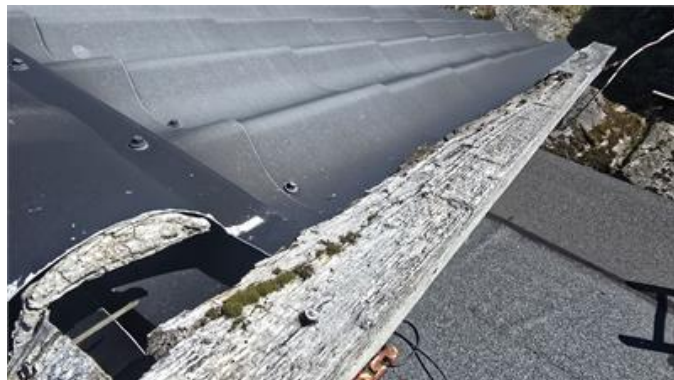
Äldre plåttak och rötskadade vindskivor.
