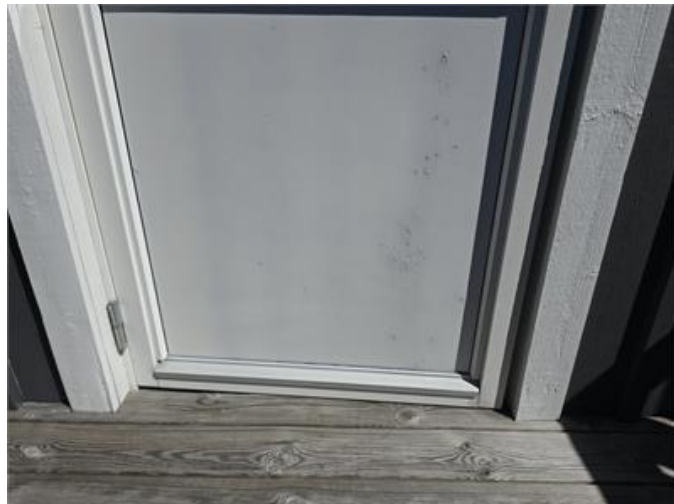
Balkongdörr med mindre färgsläpp.
