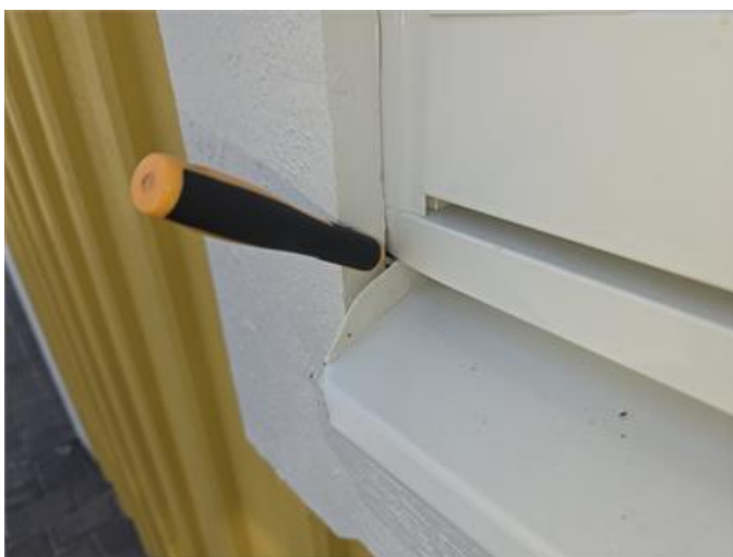
Otättheter mellan fönsterbleck & foder.
