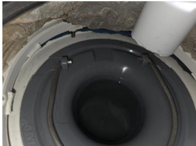
Klämring bottnar ej i golvbrunn samt manschett sticker fram under klämring
