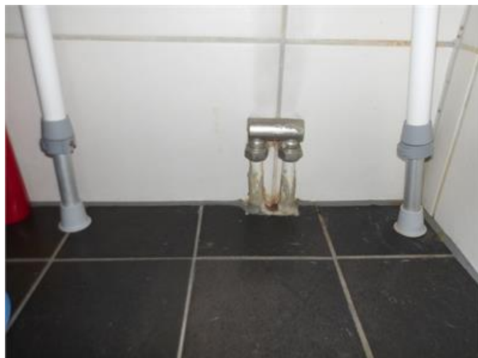
Tvättstuga/Dusch: Tätskiktet (fuktskyddet) bakom kakel och klinker går ej att besiktiga. Golvbrunnarna är enligt bedömning inte bytta vid den senaste renoveringen och förhöjningsringar finns, rörgenomföringar finns i golvet i duschen och någon klinkersplatta har tomrum (bomljud) under sig. Golvet under elpannan är i lägre nivå och har en äldre plastmatta med skador. Bristerna ger en ökad risk för
