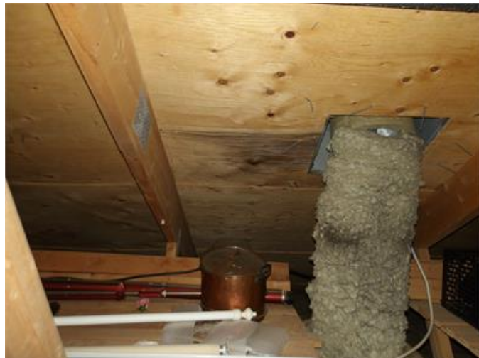
Vind: Det finns spår av fuktinträngningar på undertaket av Plywood runt rörgenomföringar och skorsten samt vid spikar
