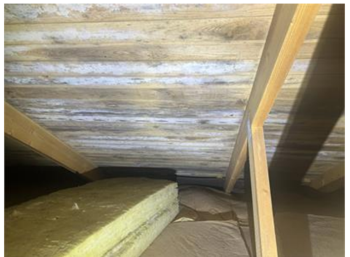
Nockvind: Mikrobiell påväxt noteras på underlagstaket.
