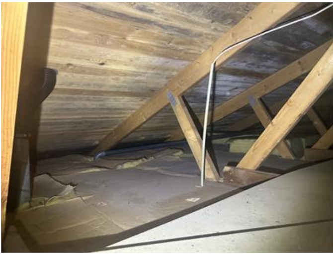
Nockvind: Oisolerade ventilations- och elrör.
