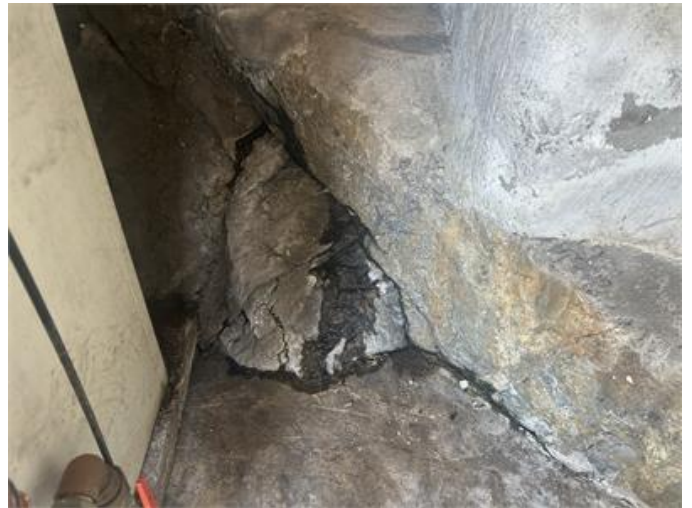
Källare: Fritt vatten noteras på berget.
