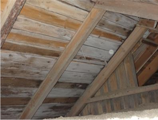
Exempel på mikrobiell påväxt på underlagstak vind.
