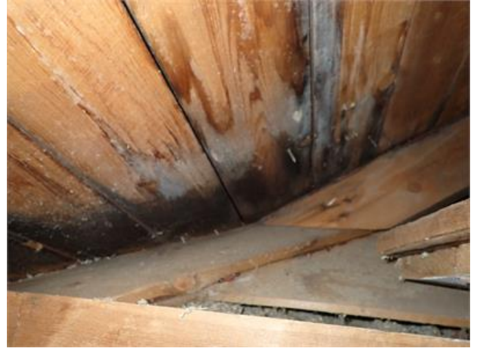
Exempel på mikrobiell påväxt och fuktfläckar på underlagstak vind.
