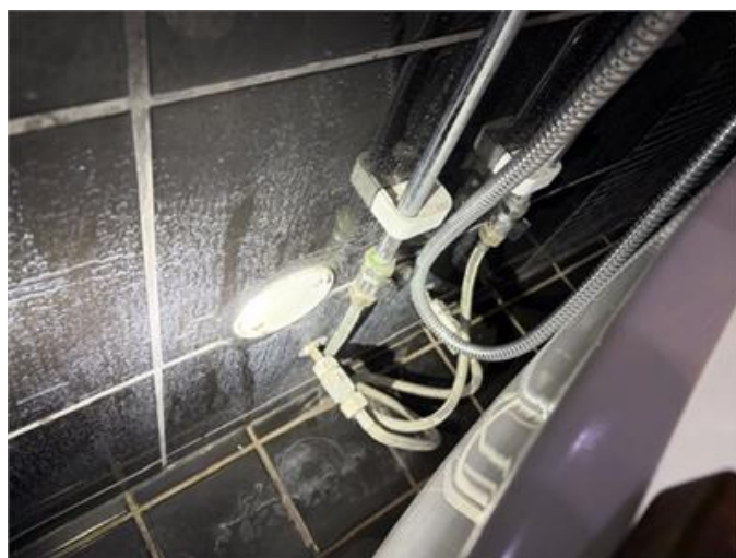
Doslock till äldre elinstallation förekommer olämpligt placerat bakom badkar. Elektriker bör kontrollera så elen är sanerad.
