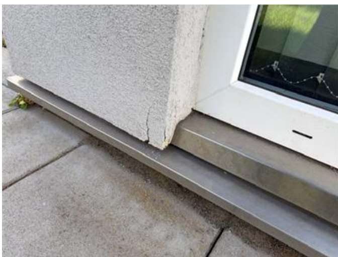
-Lokal spricka/putssläpp förekommer i fasadputs vid stora fönsterpartiet. -Plåtbleck till stora fönsterpartiet (tillbyggnad) lutar in mot fönster
