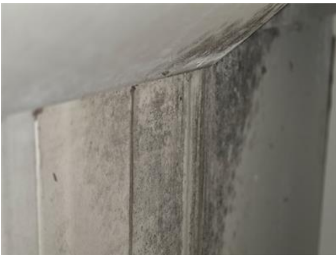
I sidvind intill murstock förekommer fuktfläckar på gipsbeklädnad. Ingen förhöjd fukt kunde indikeras men det rekommenderas att vidare undersökning av orsaken till fläckarna undersöks.
