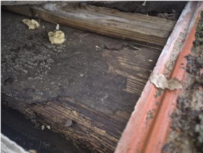
Fuktpåverkad takfot under takpannor.
