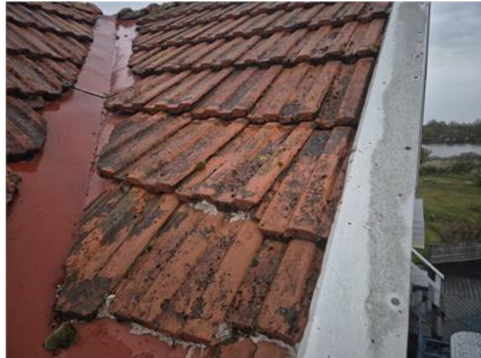
Takpannor som ligger ojämnt samt med glipa mellan pannor med risk för läckageskador.
