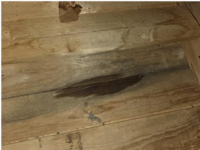
Läckage i yttertak noterades.
