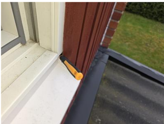
Otätthet invid fönsterbleck.
