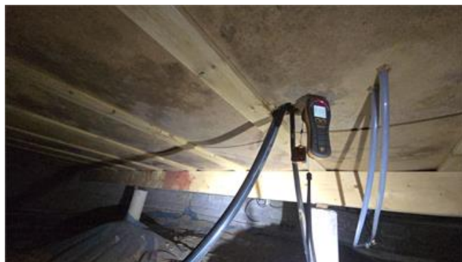
Översiktsbild, del av krypgrund. Mikrobiell påväxt på blindbotten, förhöjda värde i område kring genomföring för ingående vattenledning samt oisolerade och löst hängande vattenledningar.
