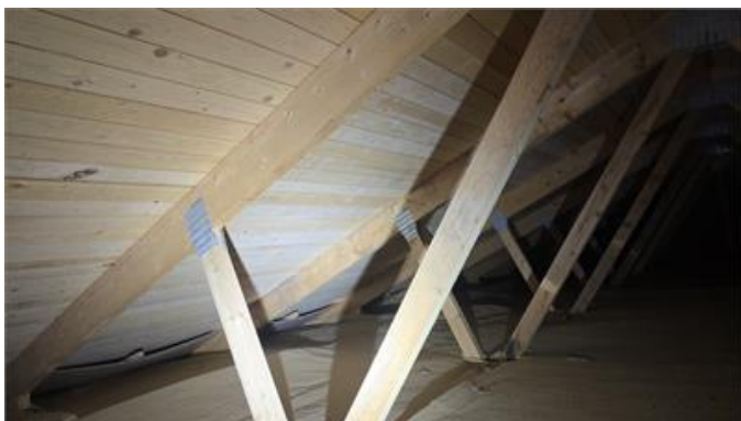
Exempelbild, mikrobiell påväxt underlagstak vind.
