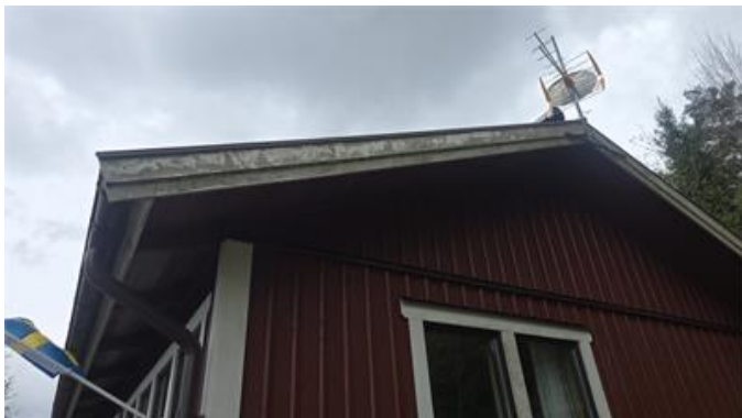
Exempelbild, underhållsbehov fasad/snickerier.
