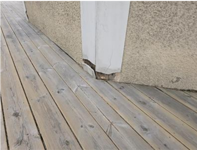
Exempel på fasadskivor som skadats.
