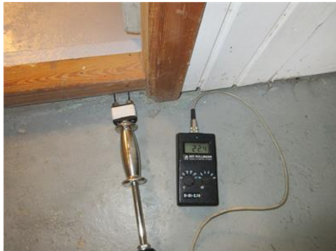
Fuktmätning tröskel i källare
