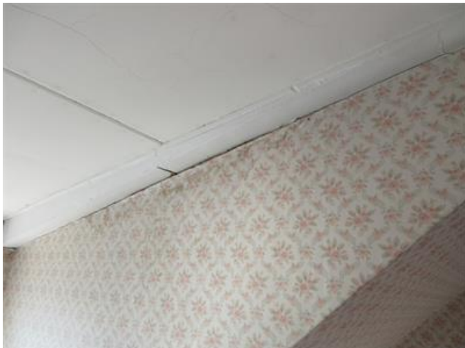
Missfärgning ytterväg i takkupa
