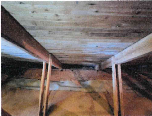
Exempelbild, mikrobiell påväxt underlagstak.
