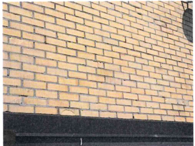
Översiktsbild, en gavel med frysskador i tegelsten/fogar.
