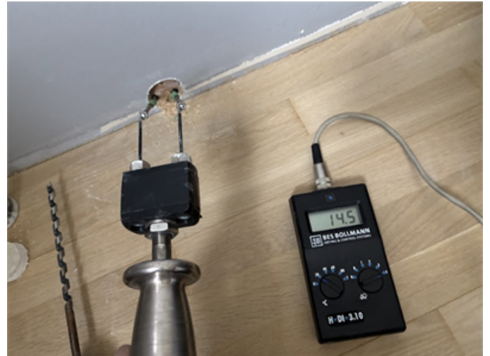
Bilden visar fuktkvotsmätning i ytterväggsyllens yttre del i vardagsrum, gränsvärde 17%FK.
