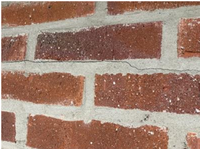
Bilden visar exempel på spricka i fasaden.
